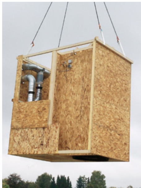
Abb. 3.09 Haustechnikzelle der Firma Morseby-Haus
