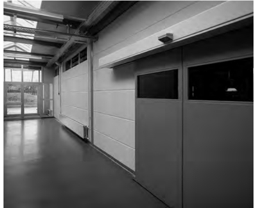
Brandwand aus Hebel Brandwandplatten.
